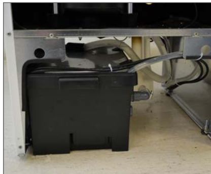
Siphon, Neutralisation und Kondensatpumpe reinigen
