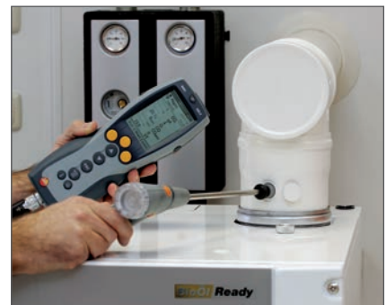
Montez l'habillage et contrôlez les valeurs de combustion
