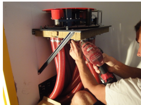
Anbringung der vollautomatischen 8-Sonden Umschalteinheit
