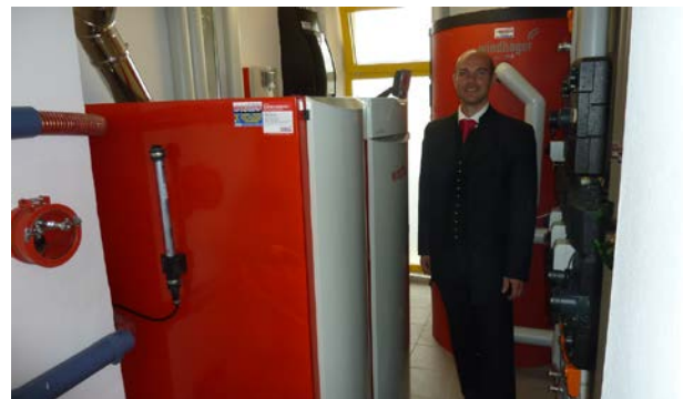
Überzeugt von der Windhager Pellets-Zentralheizung: Ing. Erwin Bodlos
