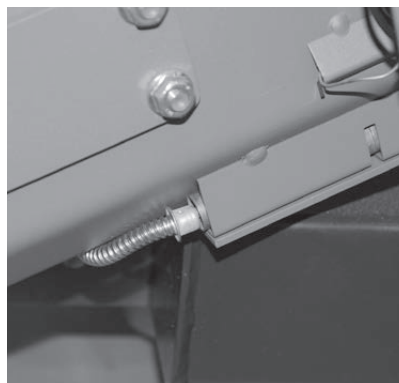
Fig. 231 Fühleranschluss für Rückbrandsicherung an der Stokerschnecke
