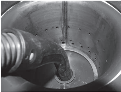
Fig. 99 Primärluftrohr in der Mitte des Brennertopfes aussaugen
