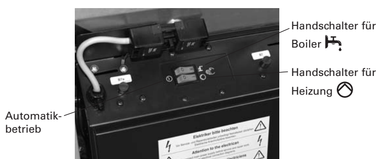
Abb. 120 Schaltfeld hinter rechter Seitenwand
