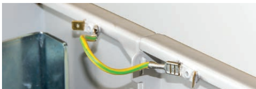
Fig. 5 Erdungskabel bei Frontblende
